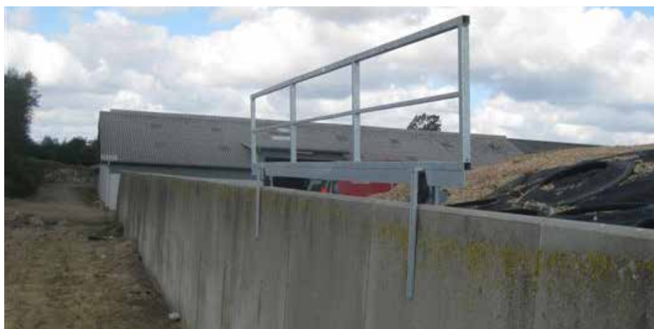
Flytbart rækværk med hjul, der let køre hen ad siloens kant i takt med, at siloen tømmes. Rækværk flyttes let med pallegafler til anden silo.
